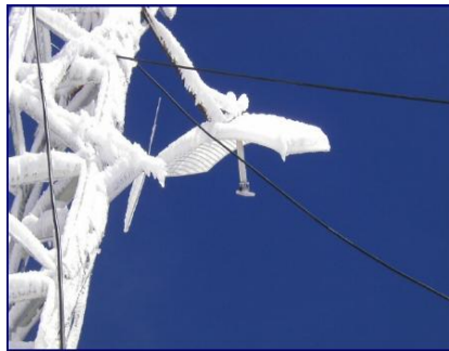
Figura 10 Antena de rejilla colapsada por el aumento de resistencia al viento causado por la acumulación del hielo
